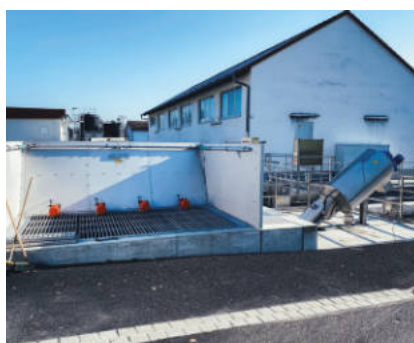
Sandannahmestation – zur Aufnahme von Straßenkehricht und Kanalsand.
